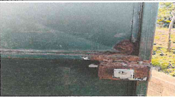
Foto 3: Chapas de puertas en mal estado.
