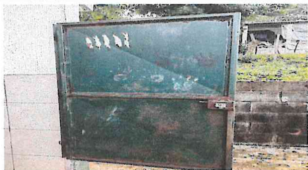
Foto 1: Puertas de Sanitario en mal estado
