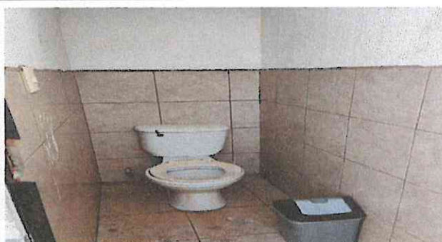
Foto 4: Sanitarios en mal estado.
